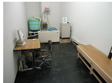
鉱業博物館の地中熱冷暖房：2部屋の冷房と床暖房。
